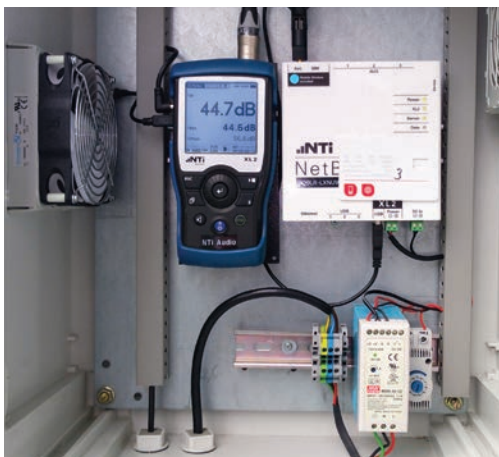
Innenausstattung eines Messschrankes
