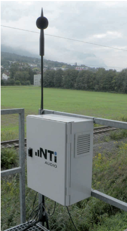
Station de surveillance du bruit avec microphone d'extérieur monté sur trépied
